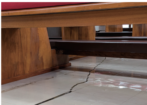
亀裂の入った床(八代教会聖堂)
