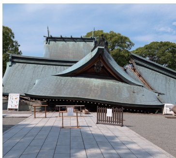
崩れた社殿(八代城跡)
