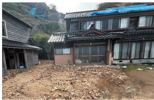
24年11月 山から崩れてた土砂が家屋に流れ込んでいる
