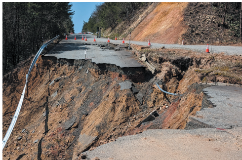
24年4月 がけが崩れ道路が寸断
