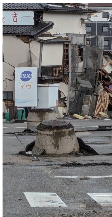
隆起したマンホール (輪島市内)
